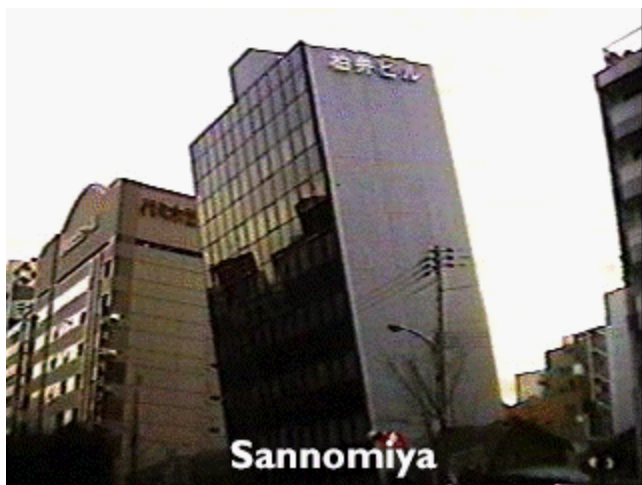
Bases anómalas del edificio del desarrollo
